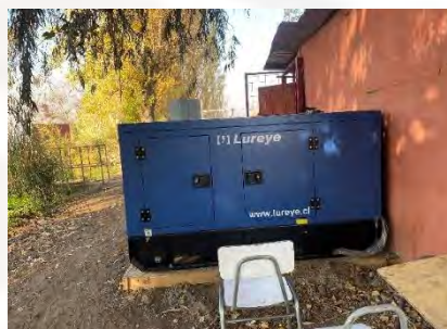
Instalación de Generadores de 22 KVA para alimentación autónoma de iluminación de canchas de fútbol
